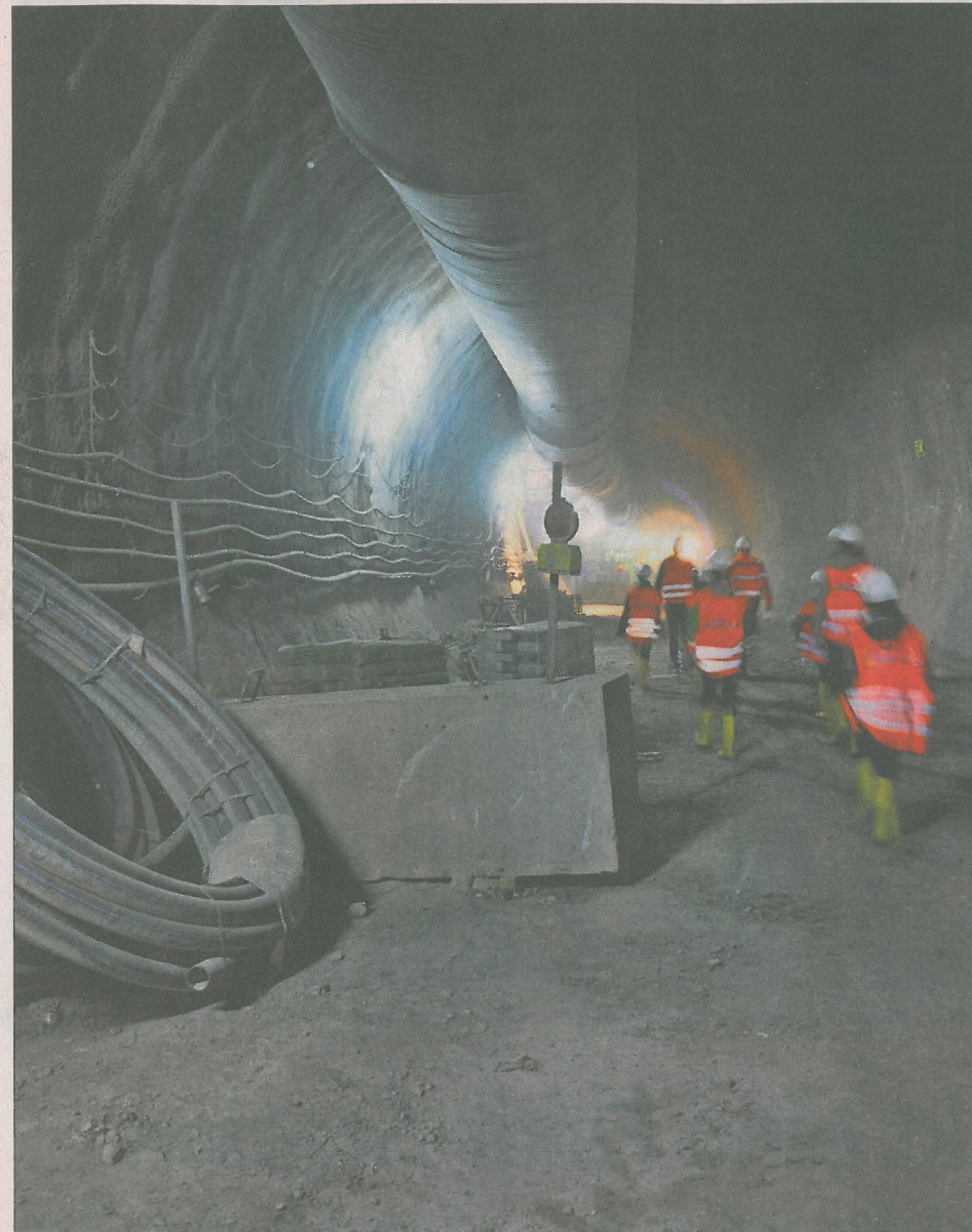
Das Stoffrohr an der Tunneldecke heißt Lutte und sorgt für frische Luft.
